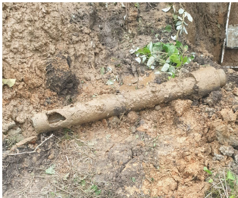
Fot. Uszkodzona rura azbestocementowa
