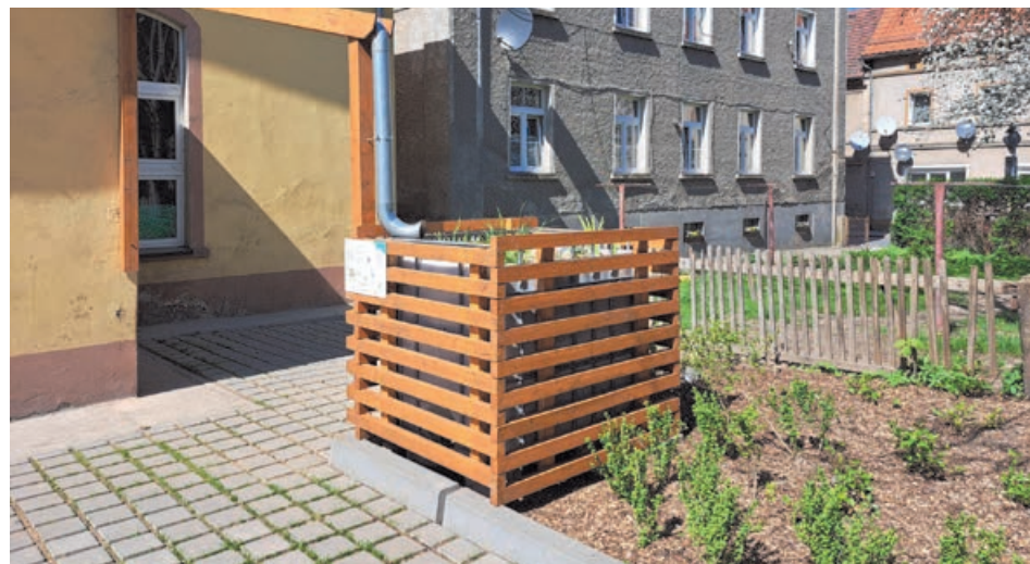
Ogród deszczowy w pojemniku na terenie zielonego parkingu przy ul. Orzeszkowej. Fot. Barbara Surmacz-Dobrowolska
