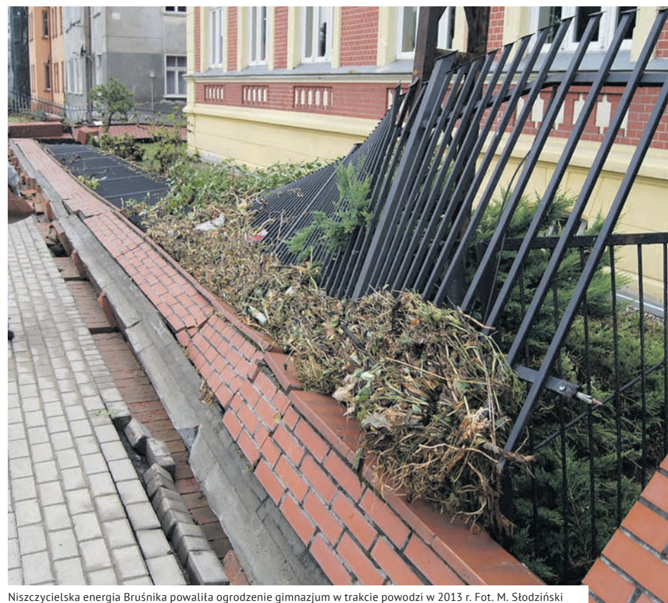
Niszczycielska energia Bruśnika powaliła ogrodzenie gimnazjum w trakcie powodzi w 2013 r. Fot. M. Stodziński
